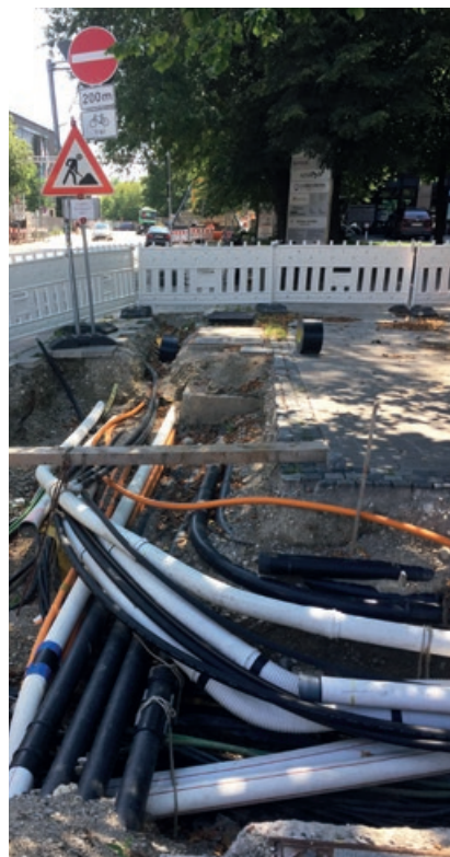
Abb. 2 – Leitungsverläufe en masse: Da kann leicht die Übersicht verloren gehen.
