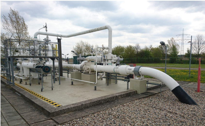
Nachhaltiger Rohstofftransport mit einer Dow-Pipeline. Anschlussstelle im Werk Böhlen (Foto: Dow)
